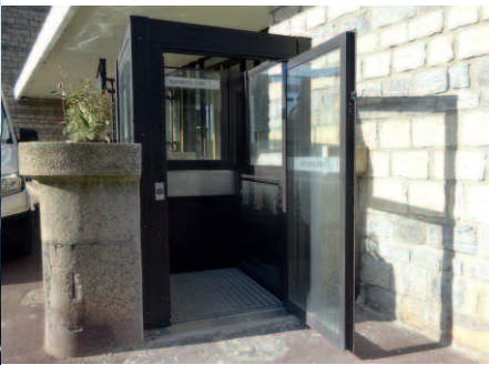
« Rattrapages » : construction d'une petite cabine d'ascenseur à fonctionnement automatique, solution efficace et peu onéreuse.
