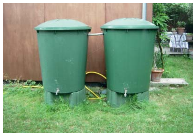
Les cuves de récupération de l'eau de ruissellement de toiture.
